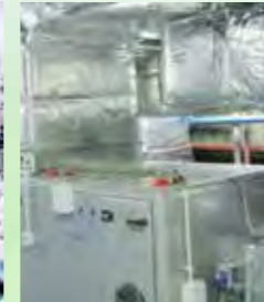
Tratamiento de Aire
